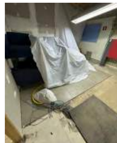
Também foram encontrados fios sem o devido isolamento e proteção
