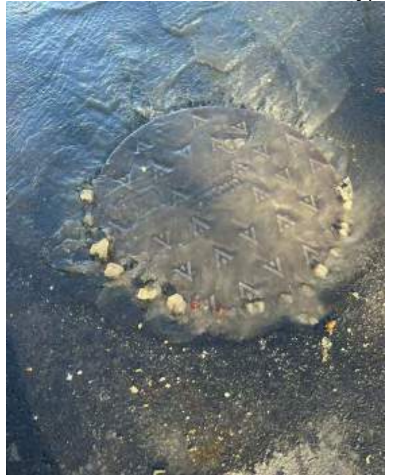
Uma das principais causas de extravasamento é a ligação irregular de água pluvial na rede de esgoto
