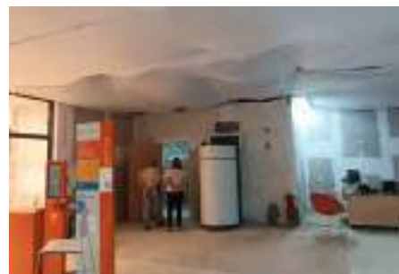
No interior da agência, em diversos espaços, as obras comprometem a segurança de bancários e clientes
