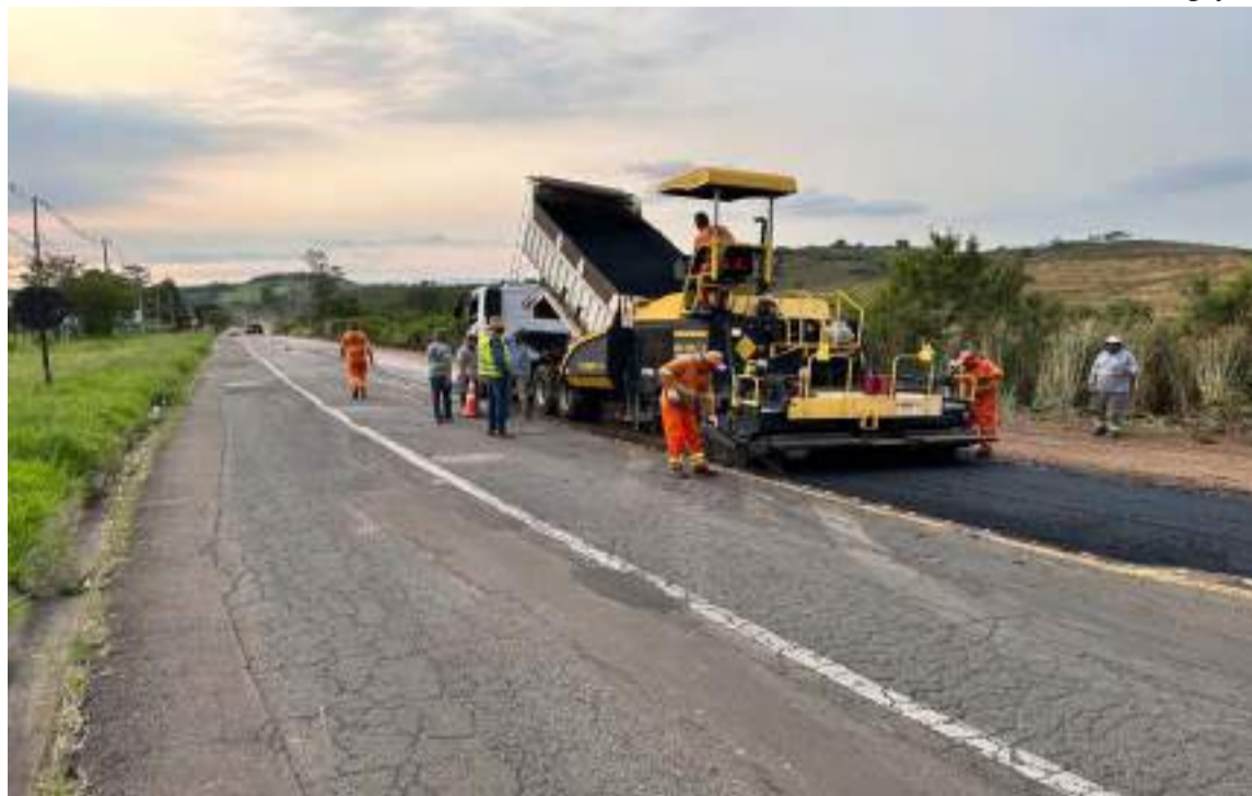
Recuperação e recapeamento da Rodovia SP-147 "Samuel de Castro Neves", que liga os municípios de Piracicaba e Anhembí
